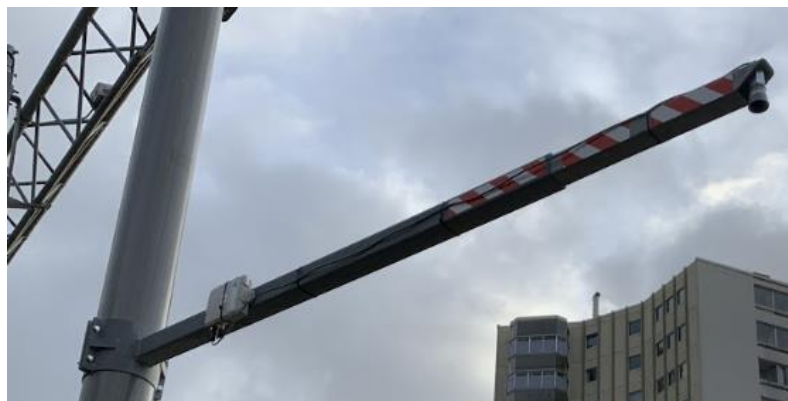
Figur 12 Teleskopfeste til snøsensor med dataoverføringsenhet (Foto: Applied Autonomy)
