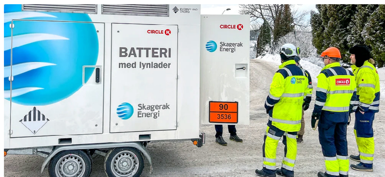
Skagerak energi utvidet porteføljen av mobile batterier i 2024, og lanserte batteri og lynlader på hjul. Disse er tilpasset anleggsplasser med mindre energibehov og/eller dårligere fremkommelighet.
