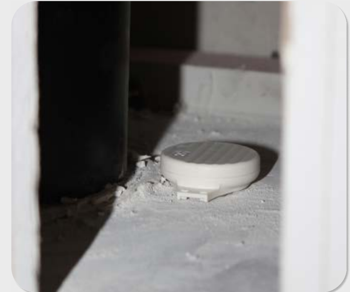
into® Sensor plassert i rørførende sjakt
