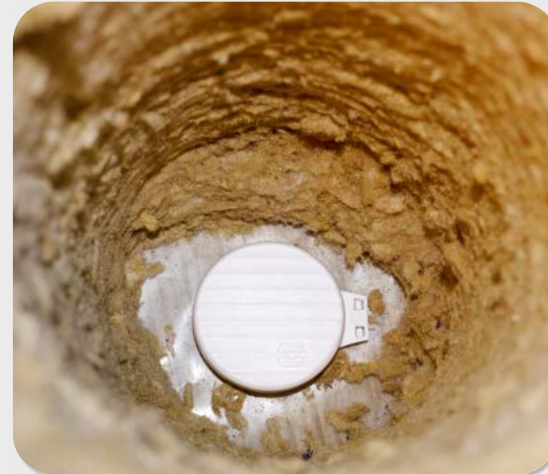
into® Sensor plassert i kompakttak
