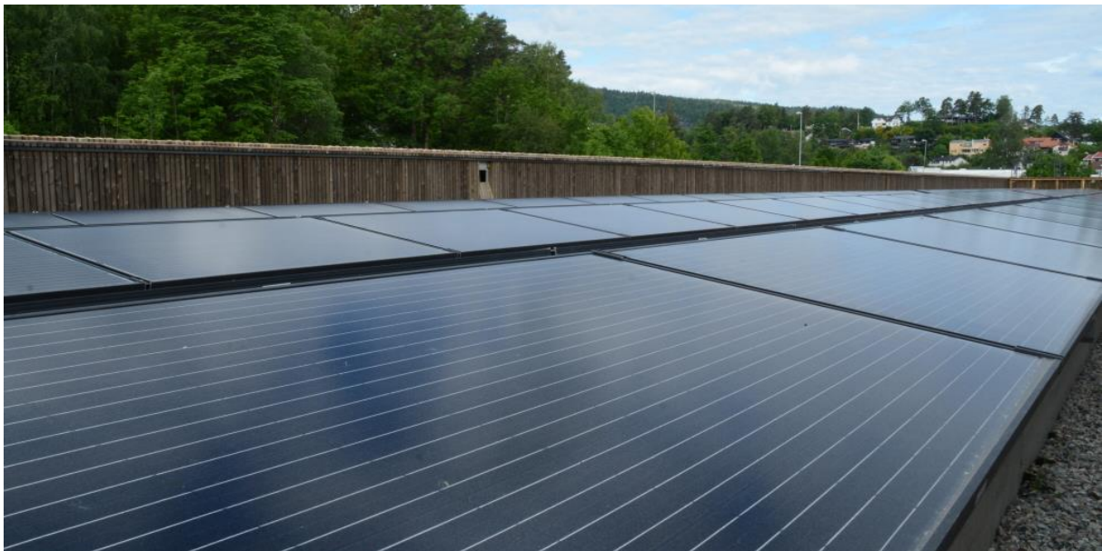
Figur 1: Solcelleanlegg på taket av Holmen svømmehall
