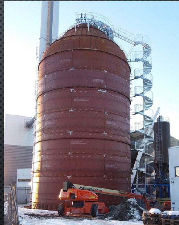
Statkraft Varme, Heimdal
